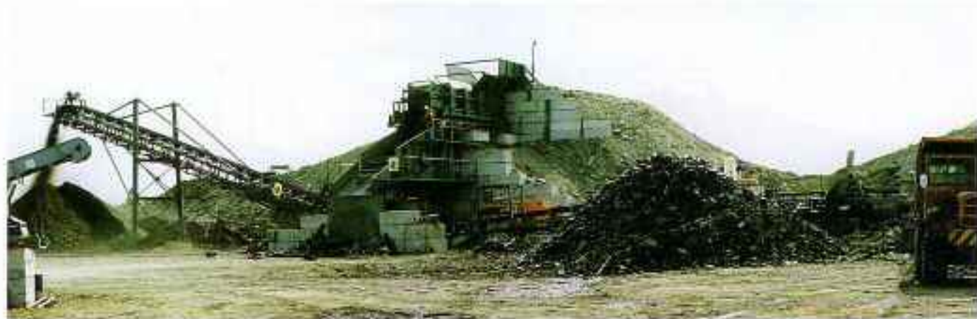
【災害廃棄物の分別施設】
