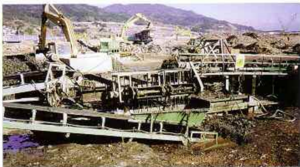
【木くずの自動掻きだし施設】
