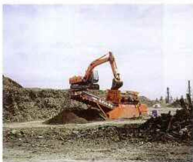
【分別機の稼働】
