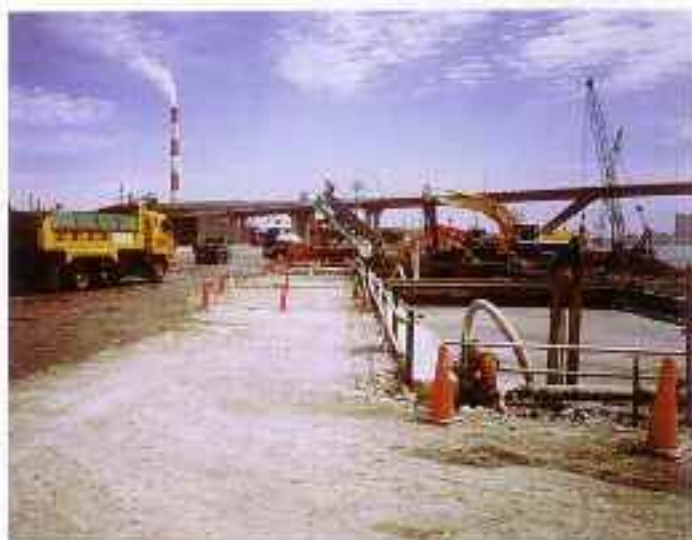
【分別プールによる浮遊物の除去】
