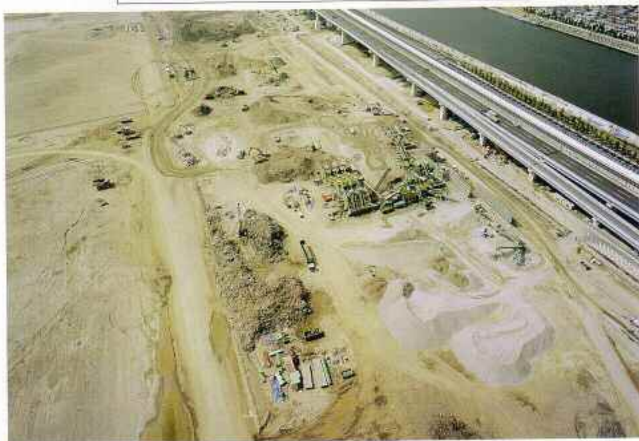
【災害廃棄物の仮置、破碎・分別施設の全景】
