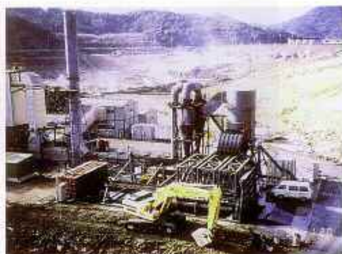
【焼却炉（バッチ炉）】
