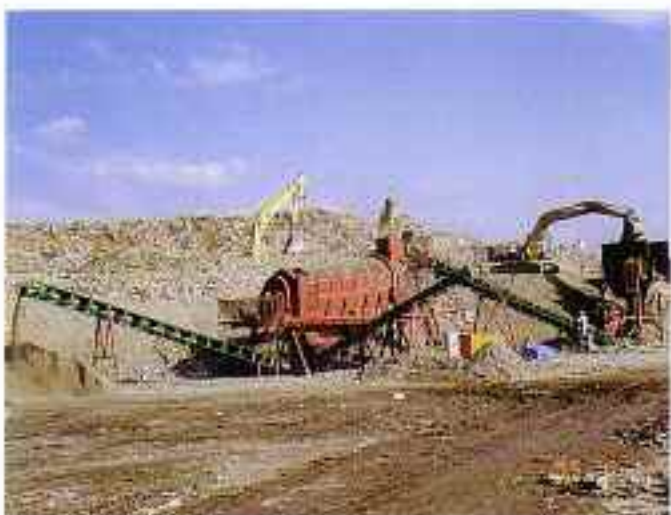
【トロンメル式分別機の稼働】
