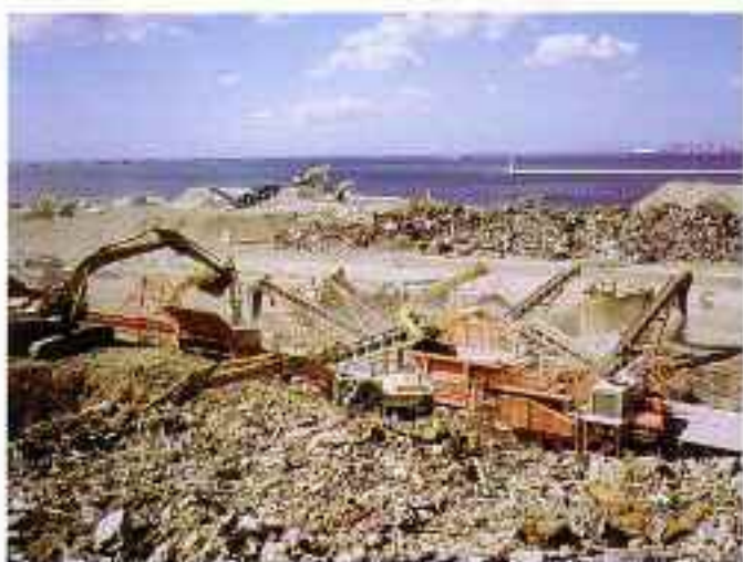
【破碎・分別設備の全景】
