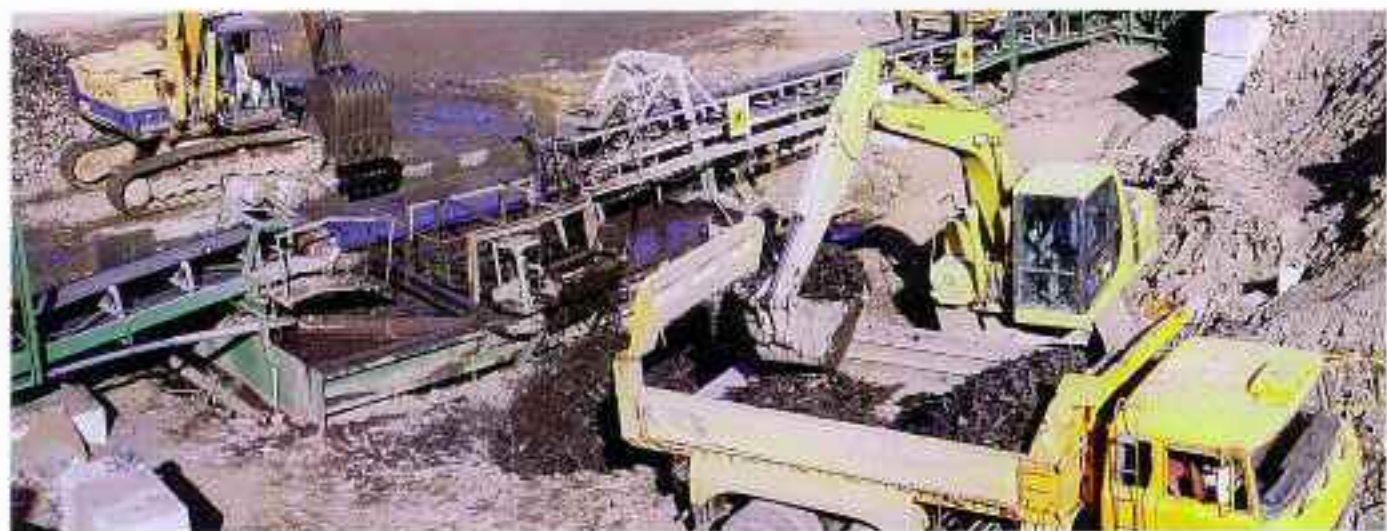
【水槽分離施設（ガレキと木くずを比重差分別）】
