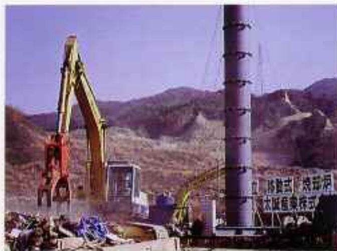
【焼却炉の稼働】
