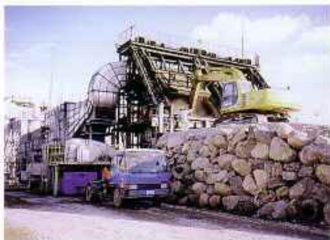
【焼却炉の稼働】
