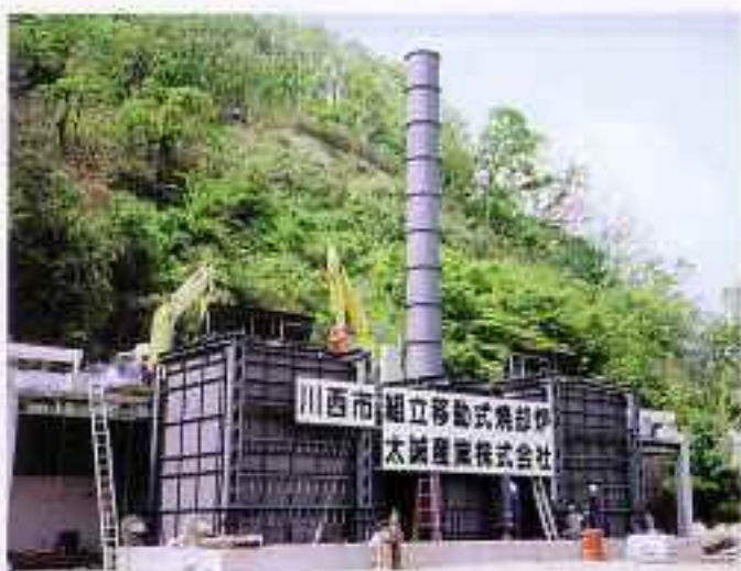
【焼却炉（3基）の稼働】
