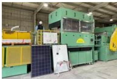
太陽光パネルのリサイクル施設
