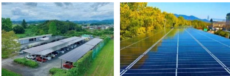
県施設へのPPA方式太陽光発電(左:加西市 右:三木市)
