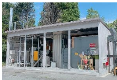
木質バイオマスボイラー (神戸市北区)
