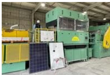
太陽光パネルのリサイクル施設
