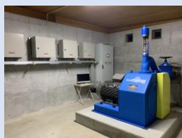
黒土川小水力発電所
