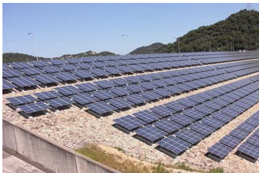
ダム堤体法面を利用したメガソーラー (権現ダム)(加古川市)
