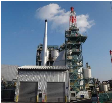
木質バイオマス発電所 (赤穂市)
