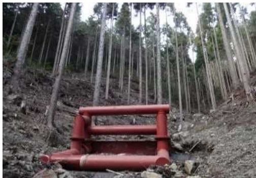
簡易流木止め施設(丹波市)
