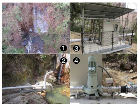
小水力発電所（神戸市灘区六甲川）
