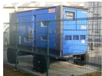
図表 93 非常用移動電源車
