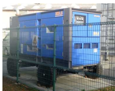
図表 92 非常用移動電源車
