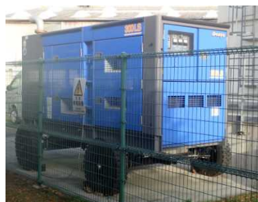
図表 89 非常用移動電源車
