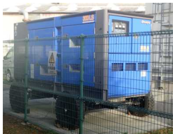
非常用移動電源車
