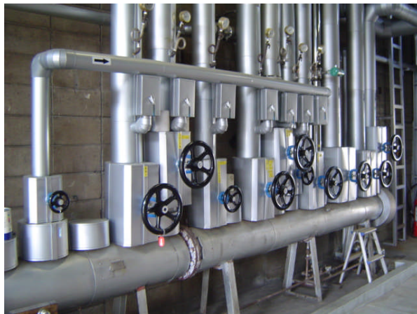
写真② スチームヘッダーからの配管及び、バルブの放熱対応
