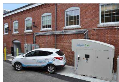
パッケージ型水素供給設備
