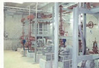
汚泥ポンプ室
