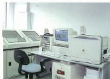
監視室内中央監視装置 (遠隔監視システム)
