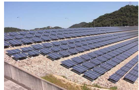
ダム堤体法面を利用したメガソーラー (権現ダム)
