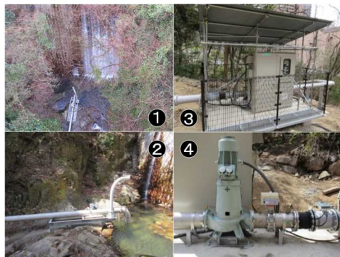
小水力発電所（神戸市灘区六甲川）
