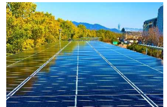
※PPA方式による太陽光発電設備(県広域防災センター)
