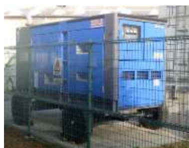
図表 93 非常用移動電源車
