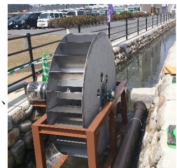
【水路に設置した小水力発電】
