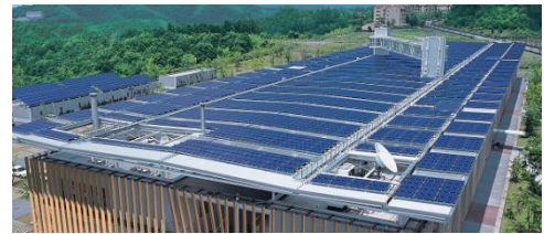
【庁舎の屋根を活用した太陽光発電】
