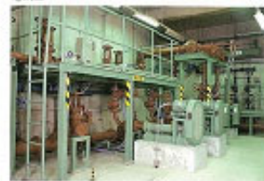
引込ポンプ室
