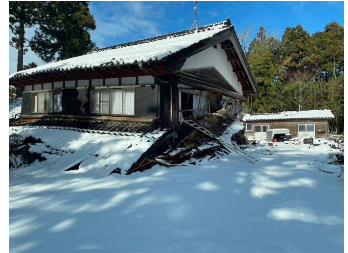
家屋被災状況
