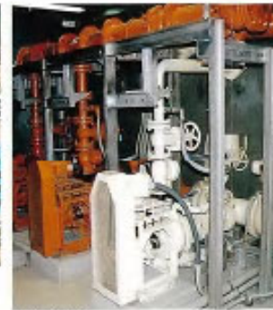
▲汚水ポンプ室
