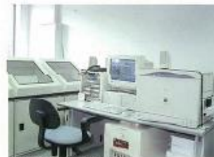
制御室(監視システム)
