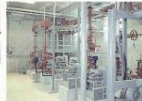
汚泥ポンプ室
