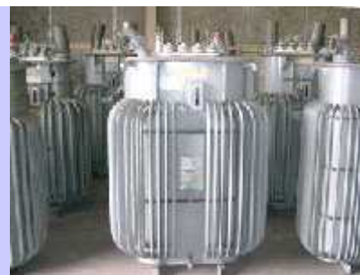
トランス (変圧器)
