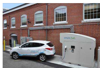
パッケージ型水素供給設備
