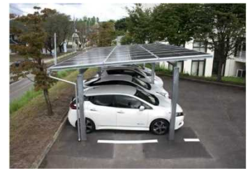
カーポート型太陽光発電設備
