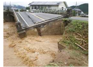
洪水による落橋
