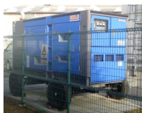
非常用移動電源車
