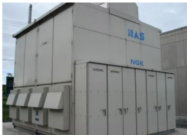
大型蓄電システム施設
