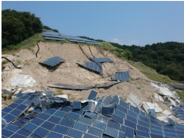
災害に起因した太陽光発電設備に係る被害例
