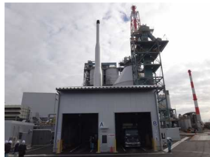
木質バイオマス発電所(赤穂市)
