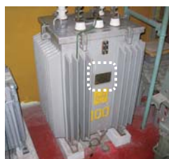
高圧トランス
