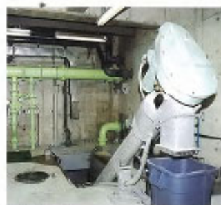
▲沈降槽-ポンプ川
