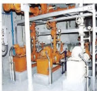
▲沈降ポンプ室
