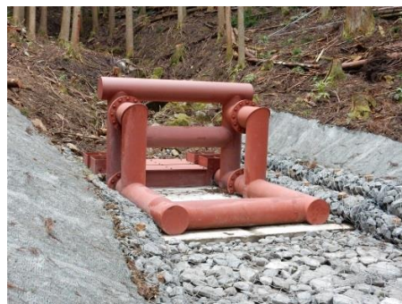
簡易流木止め施設(姫路市)
