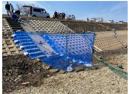
写真4 ため池からの流出防止ネット
