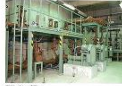
引揚ポンプ室
