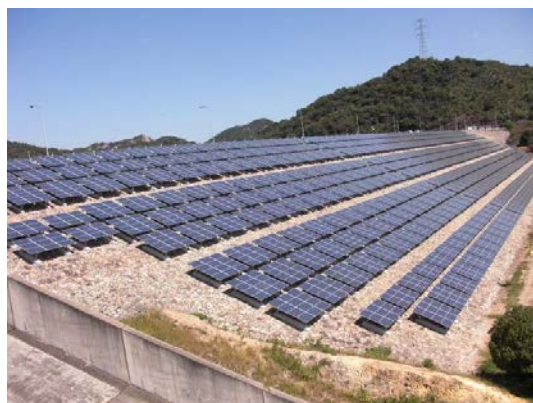
ダム堤体法面を利用したメガソーラー (権現ダム)
