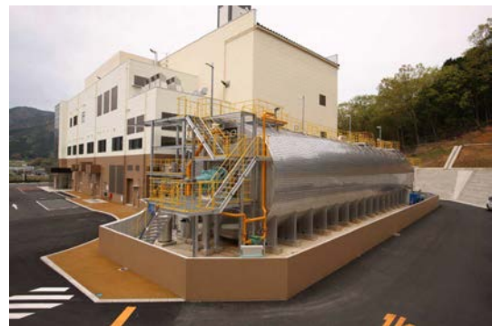
南但広域行政事務組合メタン発酵槽
