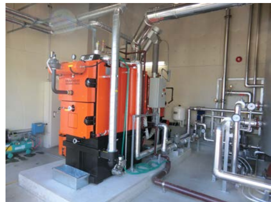
木質チップボイラー (多可町学校給食センター)
