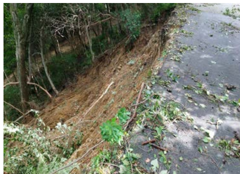
最終処分場搬入路の法面崩壊（宝塚市）
