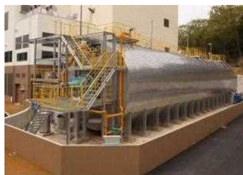
南但クリーンセンターメタン発酵槽
