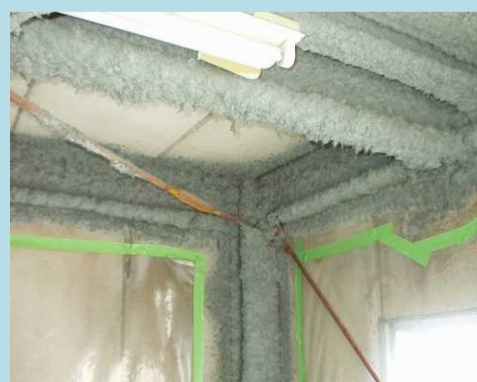
吹き付けアスベスト
