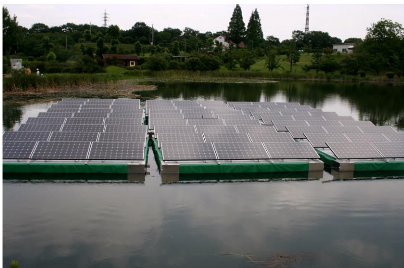
蓄水池里设有光伏发电设备
