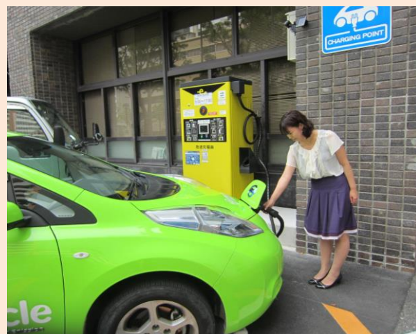
快速充电站：兵库县办公大楼 1 号馆北侧
