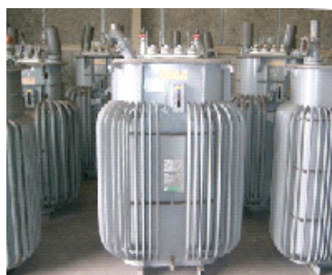
トランス(変圧器)
