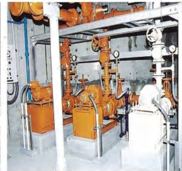
▲終沈ポンプ室
