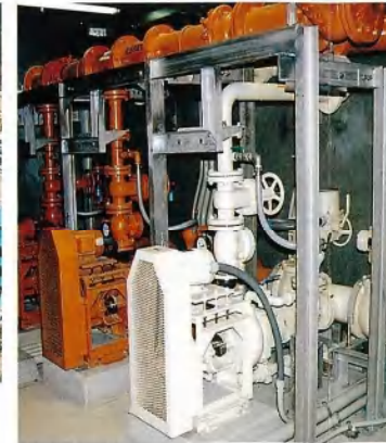
▲汚泥ポンプ室
