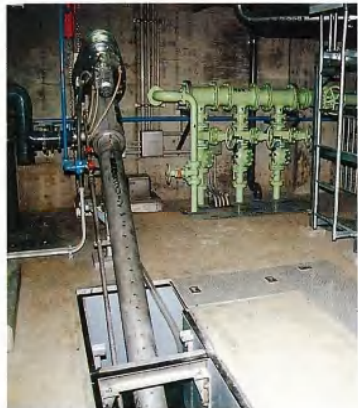
▲沈砂池・汚水ポンプ井
