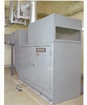
自家発電機室
