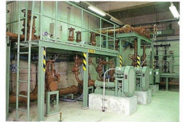
引抜ポンプ室
