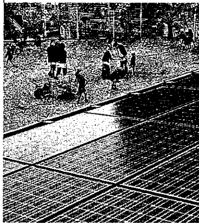
きょうとグリーンファンドが保育園の屋根に設置した太陽光パネル=高橋一徳撮影
