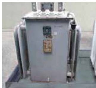
高圧トランス
