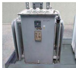
高圧トランスの例
